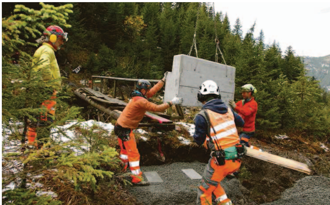
Per Helikopter werden die vorgefertigten Betonsöckel versetzt, damit die alte Brücke (im Hintergrund) ersetzt werden kann.
